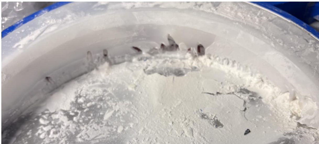
Figura 1 - Desgaste progressivo da vedação observado na válvula borboleta convencional originalmente instalada na planta.
